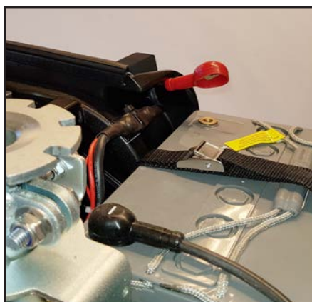
Av säkerhetsskäl lossas en pol på ett av batterierna.
